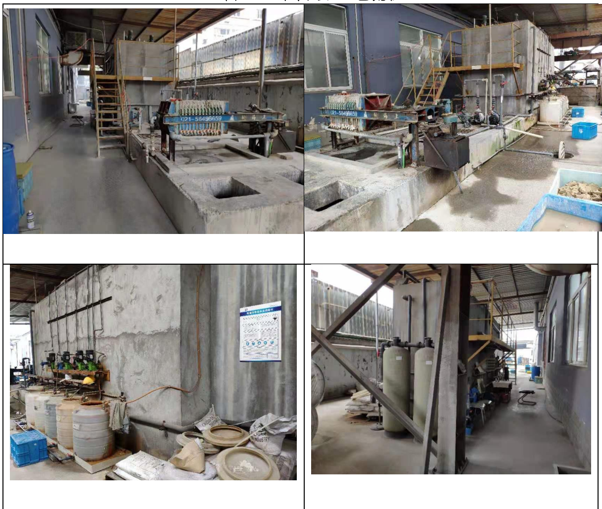
图 4-2 废水处理设备照片
