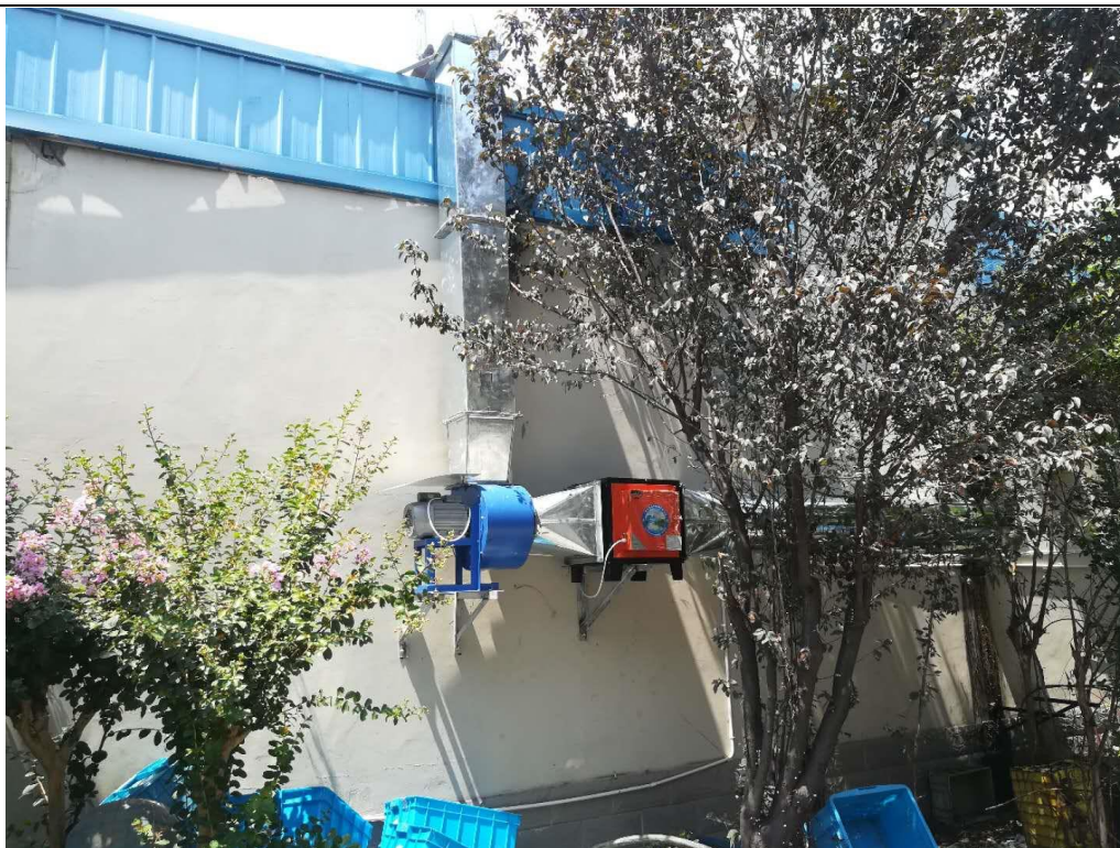
图 4-7 食堂油烟废气处理设施图
